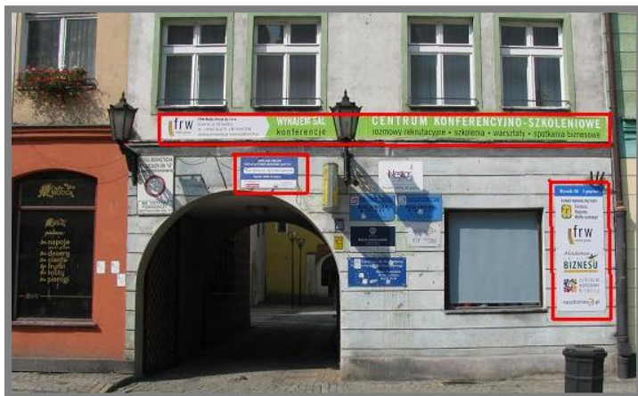
Fot. Tablice reklamowe na elewacji – samowola budowlana – rok 2016
